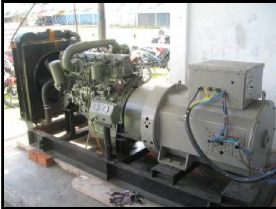
Gambar 23. Generator Set dengan Penggerak Motor Diesel
