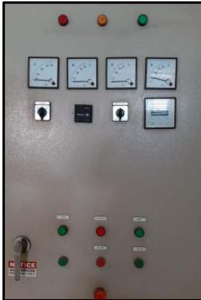
Gambar 9. Panel Utama Listrik
