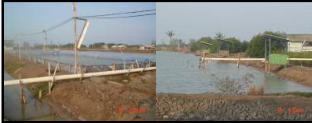
Gambar 10. Jaringan Kabel Listrik di Tambak
