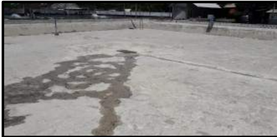
Gambar 10. pelataran kolam beton yang retak
